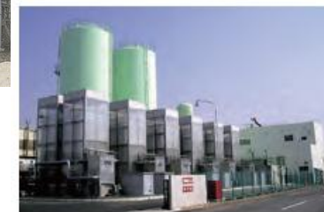
LNG satellite terminal
